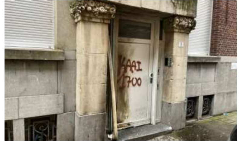
De voordeur raakte beschadigd. © BFM
