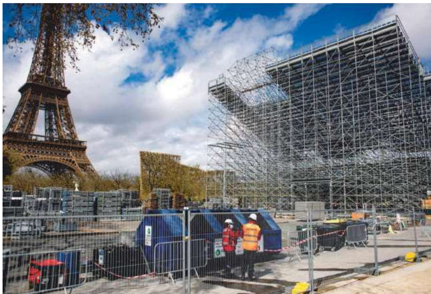
Bouwwoede aan de voet van de Eiffeltoren, waar het beachvolleybal zal plaatsvinden. © AFP
